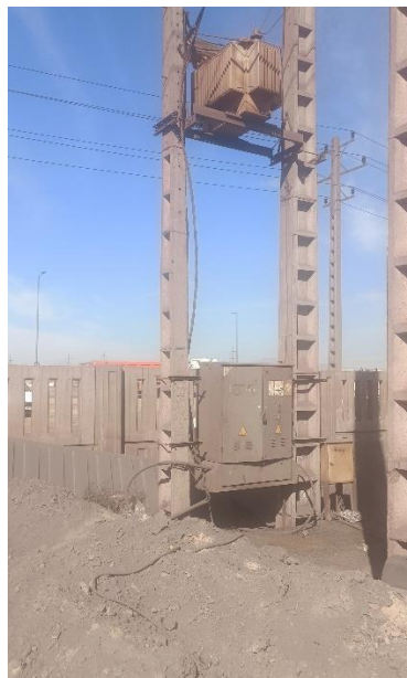
شکل ۲: تابلو توزیع ترانس 315 kVA
