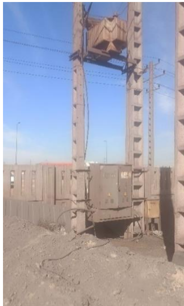
تابلو توزیع ترانس 315 kVA و محل نصب دیزل ژنراتور مجموعه دیو
